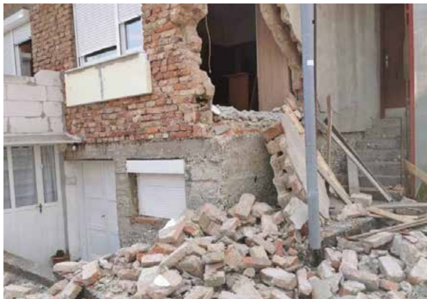
Oštećenja kuća u okolici Zagreba
